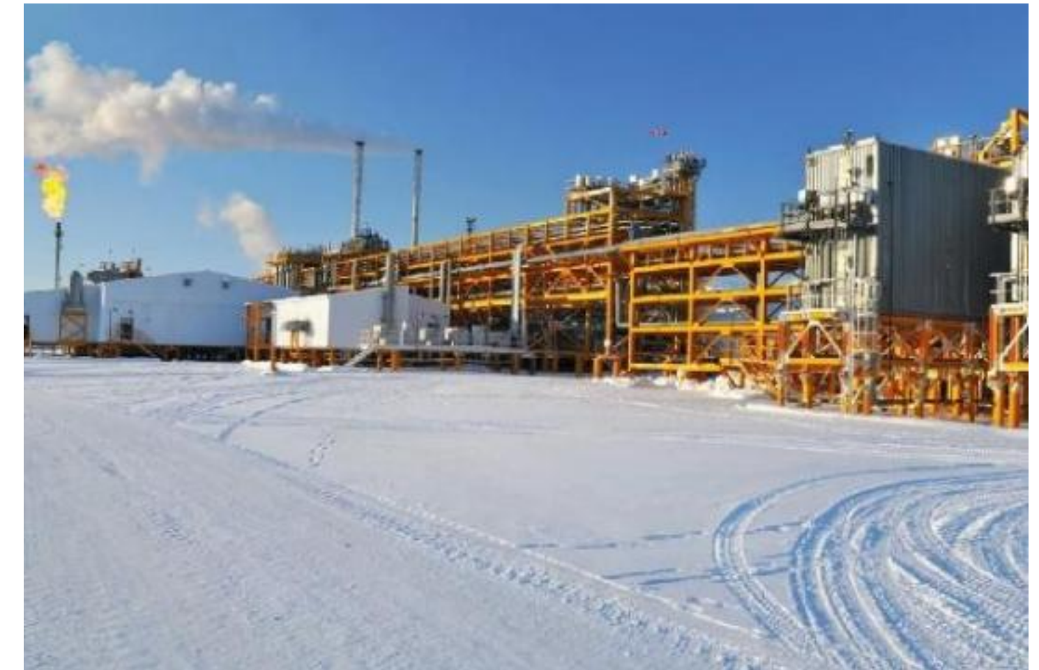
Очередь 3 проекта обустройства Харьягинского месторождения. Резервуары хранения нефти и воды, кустовая установка добычи нефти
